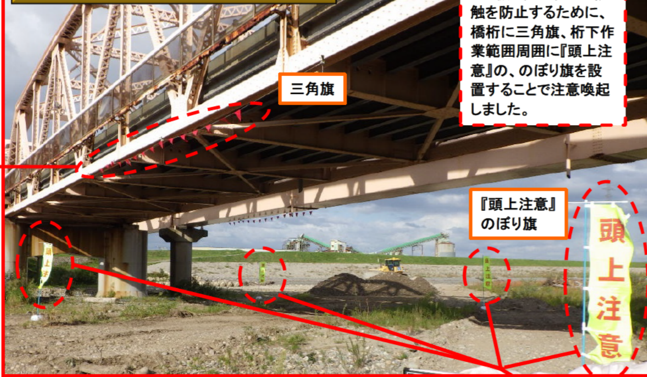
桁下作業時の注意喚起明示
